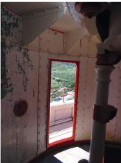
3- Vue sur l'accès vers la terrasse. Les élévations sont en tôle acier peinture sur ossature acier. Présence de points de rouille
