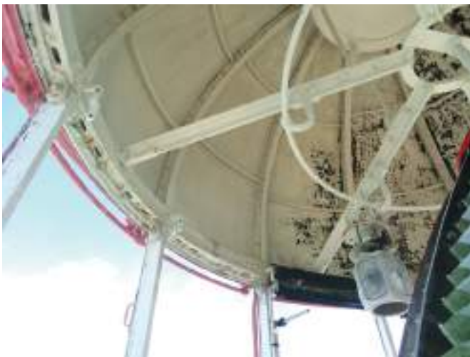
1- Dôme en structure acier et tôle peinte, trace de rouille
