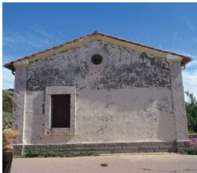
4- Pignon Nord-Ouest, dégradation des enduits plus marquée
