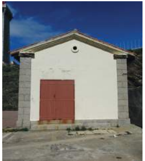
2- Élévation Sud-Ouest - présence d'une porte percée récemment
