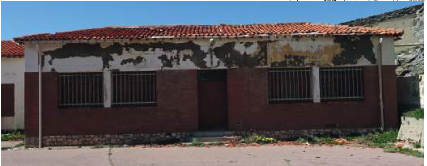
1- Élévation Sud Ouest sur cour. Le bâtiment des années 50 remplace un bâtiment démoli. Édifice très dégradé avec des problèmes structurels, de ruine de la couverture et de résurgence de sel.
