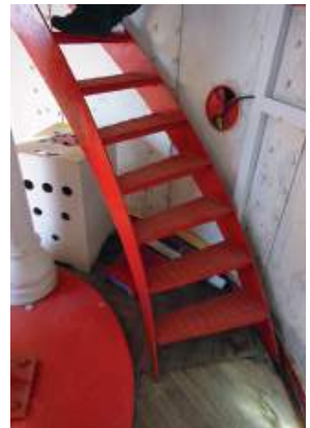
3- Escalier d'accès à la coursive supérieur. Escalier en tôle larmée peinte sans contremarche et garde-corps
