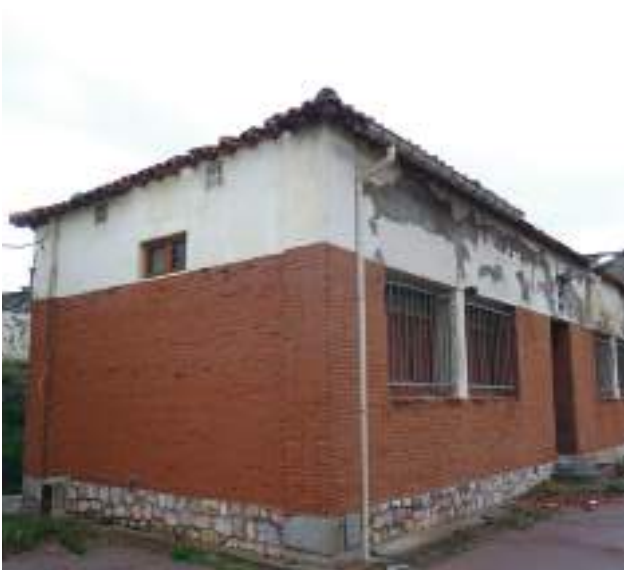
3- Pignon Sud-Est. La façade est quasi aveugle, on observe l'altération des revêtements de brique des murs
