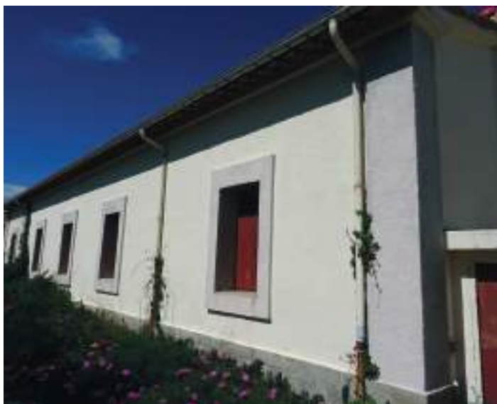
1- Élévation Ouest côté Sud-Ouest - façade récemment restaurée. Les chaînes d'angle et entourages de baie en pierre de granite ont été enduites
