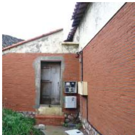
4- Accès secondaire sur l'édicule arrière. Les altérations son similaires au bâtiment principal
