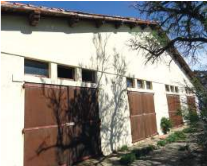
1- Élévation Ouest côté Nord - présence de plusieurs fissures verticales
