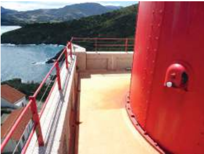
1- Vue sur la terrasse : sol en résine, parapet en granite et garde-corps acier avec câbles
