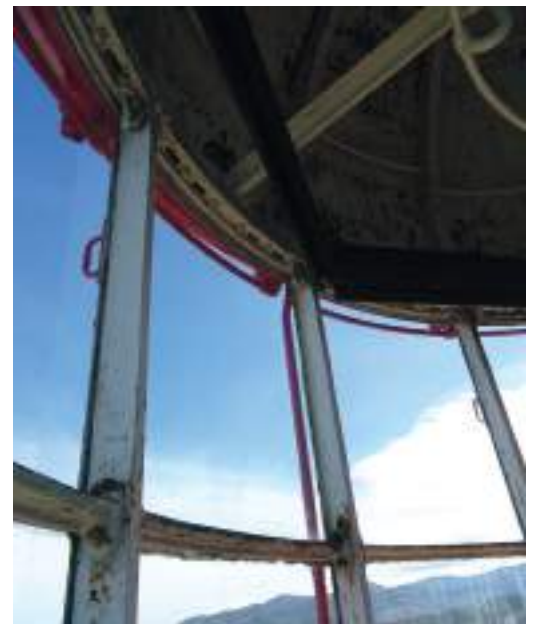
2- Élévations en ossature acier, traverse en cuivre et verre cintré. Certains verres cassés ont été remplacés par des polycarbonates. Des trous sur les traverses permettent d'évacuer les eaux de condensation
