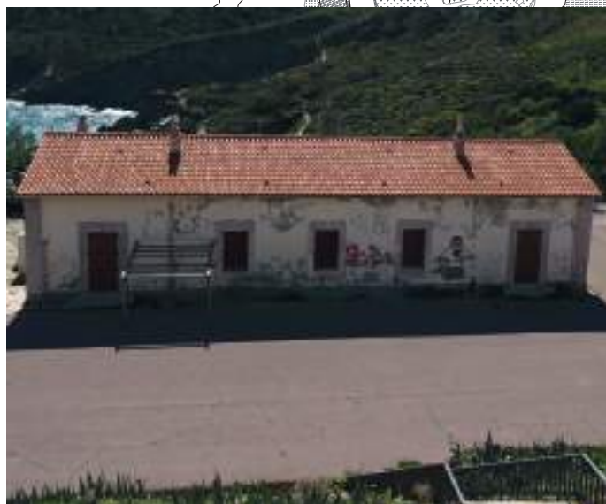
2- Élévation Nord-Est. L'élévation présente un état d'altération plus avancé que celle opposée, en particulier la résurgence de sel en partie basse
