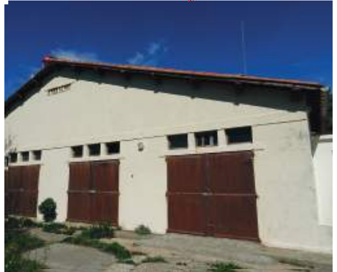
2- Élévation Est côté sud - Façade pignon placée sur la longueur, altération de certains abouts de poutres
