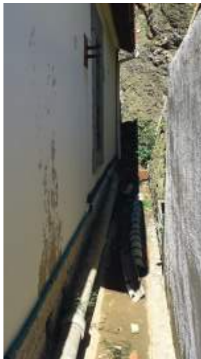
4- Élévation Sud-Est - présence d'une baie et de canalisations apparentes
